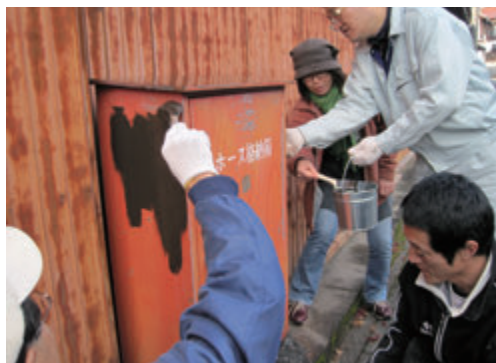
ホース格納箱は街並みの色に合わせて化粧直し
